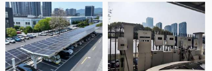
厂区光伏发电
